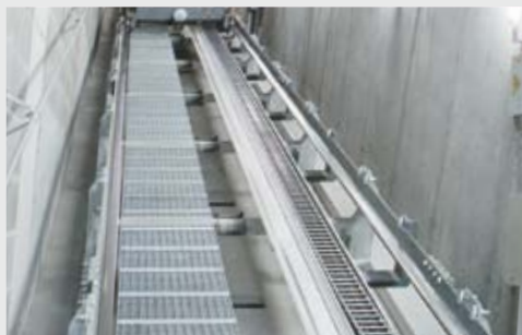
Schacht mit Steg für Wartungsarbeiten
