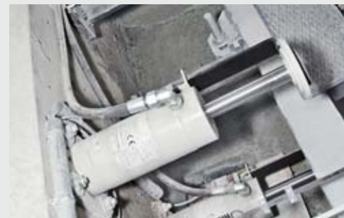
Die Sicherheitspuffer in der Schachtgrube
