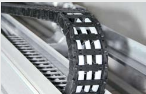
Stromzufuhr zur Kabine mittels Energiekette
